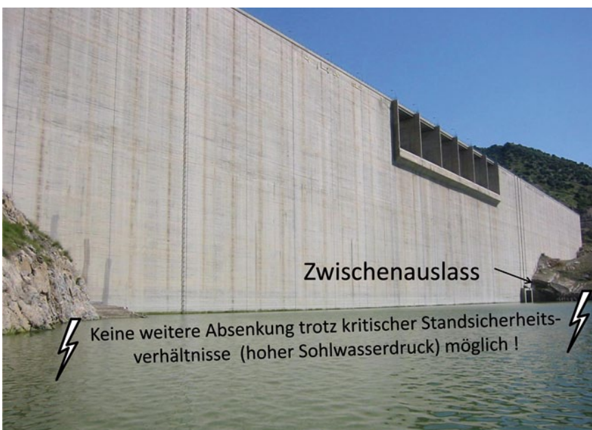
Bild 4: Situation an einer Gewichtsstaumauer ohne Grundablass in Nordafrika kurz nach dem Ersteinbau
