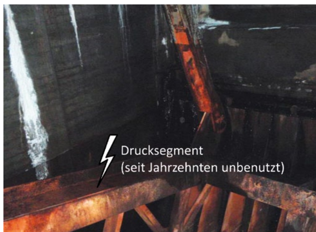
Bild 1: Nicht benutzter Verschluss eines Grundablasses
