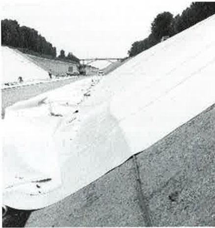
Bild 5: Einbau des Glasfaserkabels unmittelbar unter der Membrandichtung Fig. 5: Installation of the fibre-optic cable directly underneath the geocomposite
