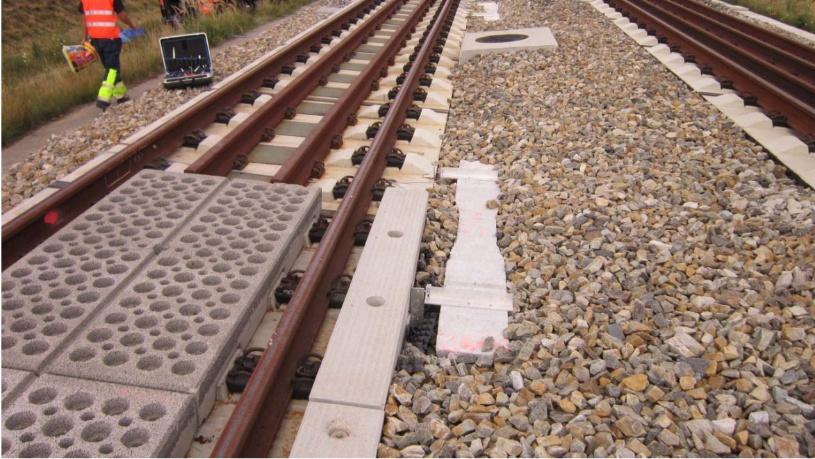
Neubaustrecke Wien – St.Pölten – Messstelle Übergang Feste-Fahrbahn - Schotteroberbau
