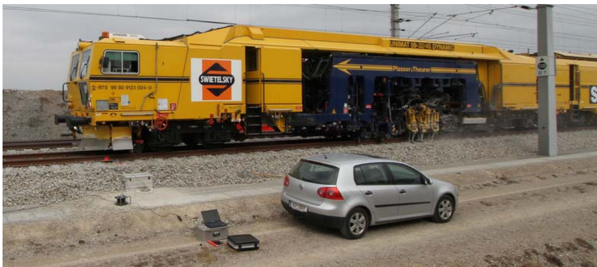
Neubaustrecke Wien – St.Pölten – Messstelle Schotter
