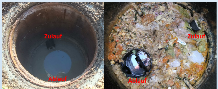
Abb. 2: links: Nicht funktionierender Fettabscheider aufgrund des Fehlens der Trennwände; rechts: Fett- oder Speiseresteabscheider?
