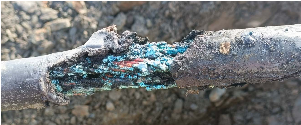
Abbildung 22: Die Schadstelle in der Stromleitung zum Hinteren Eis wurde endlich gefunden und repariert. Trotz dieses Schadens (Blitzschlag) konnten unsere Installationen acht Jahre lang mit Strom versorgt werden. Die einzelnen Leiter waren aufgespreizt und das Luftvolumen dazwischen reichte meist zur gegenseitigen Isolation aus. Bei Feuchte oder Gewittern jedoch nicht mehr und die Leitung blieb durch Kurzschluss tot. Foto: Rainer Prinz, 30.09.2024
