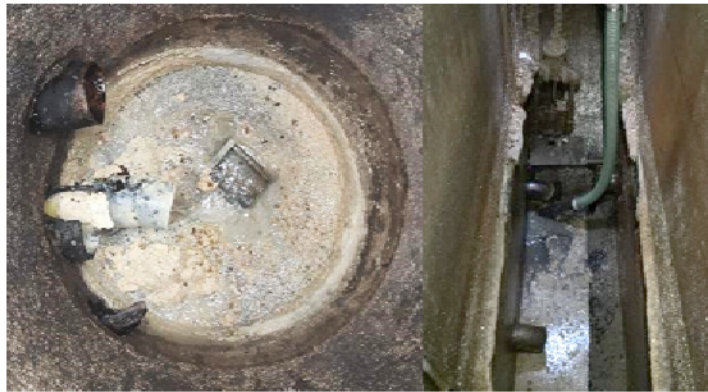
Fett in Kanal und Pumpstationen
