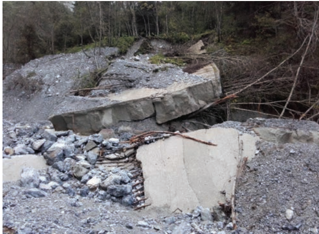
Abbildung 1: Gebrochene Sperre des Pinnisbaches
