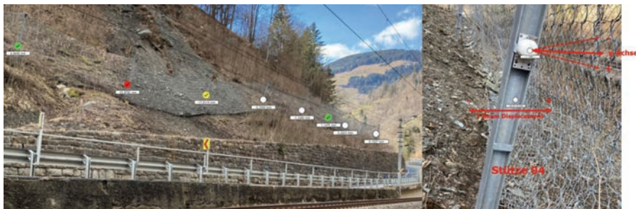
Abbildung 2: Steinschlagdetektion durch Erhebung der Winkelveränderung der Stützen eines Steinschlagschutznetzsystems mittels Kipp- und Beschleunigungsmessung. Zweck: Zustandsmonitoring des Rückhalterauges (CM) sowie indirekt zur Bewertung der strukturellen Integrität des Netzsystems. Aktualisierung: minütlich, Information bei Schwellwertüberschreitung. Status: operativ.
