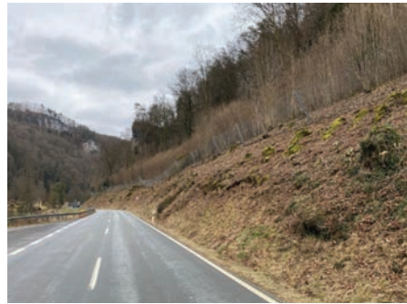
Abb. 4: Ansicht nach dem Freischnitt mit nun zugänglichem Steinschlagschutzzaun (Quelle: StBA Bamberg)
