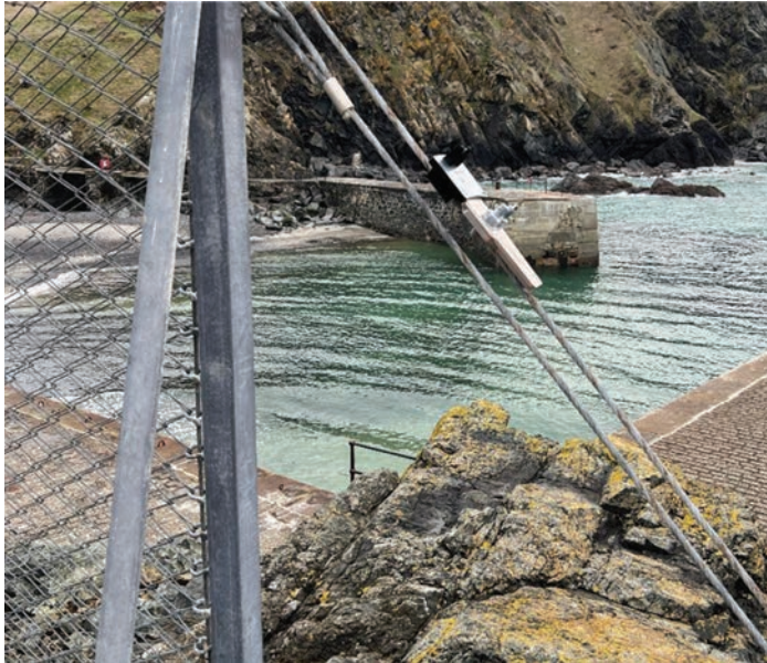
Abbildung 6, Barriere mit installiertem GUARD, an den Seilen sind bereits Spuren von Korrosion erkennbar
