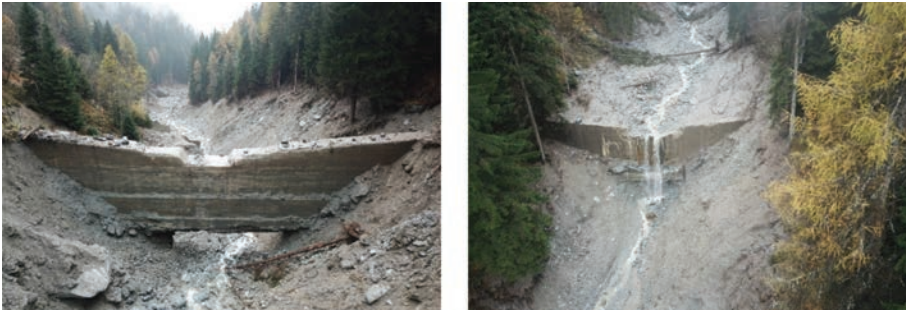
Abbildung 2: Sperren des Rotian Baches nach dem Murgang mit unterschiedlichen Schadbildern
