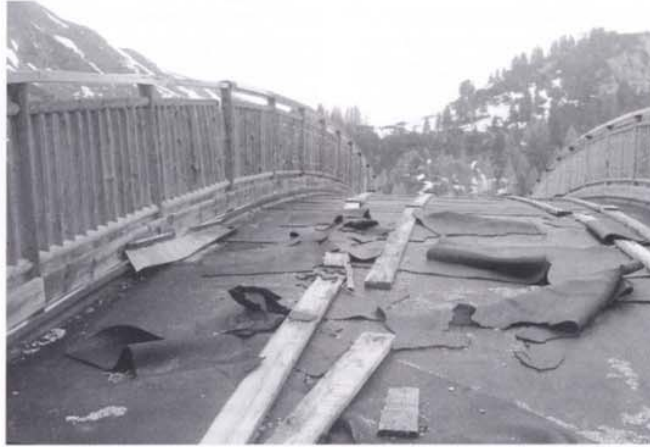
Schadhafte Verschleißschicht und Abdichtung bei Holzbrücke – Probleme sind vorprogrammiert
