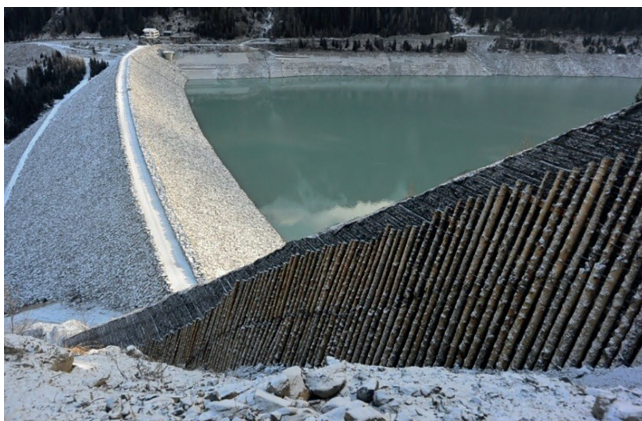
Bild 3. Schutzdamm gegen Felslawinen und Steinschlägen mit bergseitiger Verkleidung Foto: R. Hofmann Fig. 3. Rock avalanche and rockfall embankment with uphill facing Source: R. Hofmann
