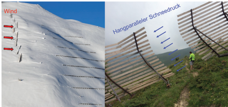
Bild 4, Beschädigter Triebsschneezaun Valtschamela, Churwalden (GR). Der Triebsschneezaun besteht aus 4 m breiten Einzelelementen, die mit vier Mikropfählen verankert sind. Durch den seitlichen in der Falllinie wirkenden Schneedruck wurde der Zaun in Talrichtung deformiert. Auf die einzelnen 4 m langen Elemente des Triebsschneezauns wirkte ein resultierender Schneedruck von rund 120 kN (Foto, links TUR, rechts SLF S. Margreth).
