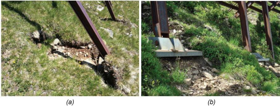
Bild 3, (a) Ausgleiten der Stützen infolge Überlastung, (b) Fortschreitende Erosion im Bereich Stützenplatten
