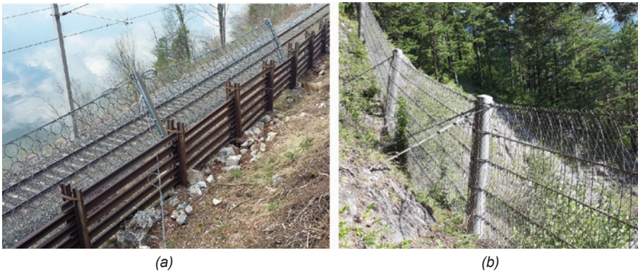
Bild 1, (a) Bauwerke der Phasen 4 (Steinschlagschutznetz) und 2 (Schienenwand), (b) Bauwerk der Phase 3 (Drahtseilsperre mit starrem Stützenfuß)
