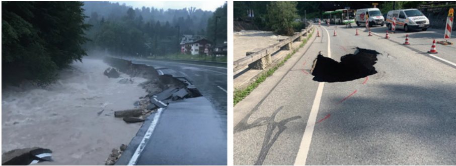
Abb. 2: Zerstörte Stützmauer Bahnhofsvorplatz Berchtesgaden (links) und unterspülte Stützkonstruktion am Durchlassbauwerk bei Gartenau (rechts).
