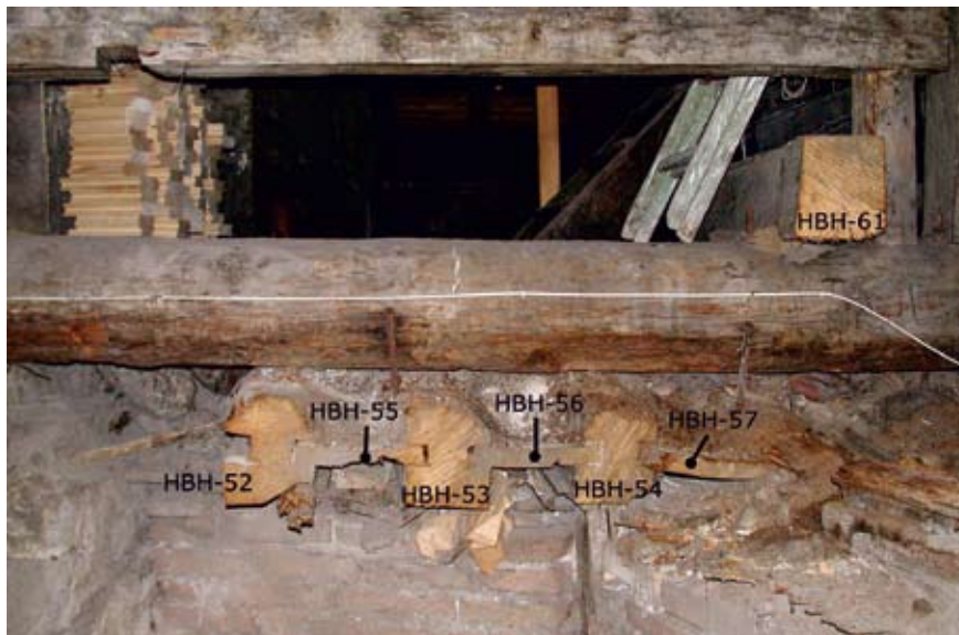
Abb. 7: Reste der Bohlenbalkendecke sowie die Bundtram-Konstruktion im östlichen Teil des Dachraums des Südtrakts, HBH-52 bis HBH-57: beprobte Bohlenbalkendecke, HBH-61: Bundtram. Foto: K. Nicolussi.
