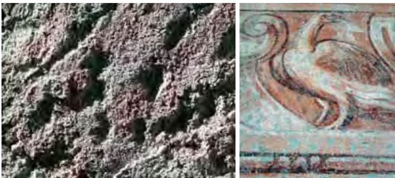
Ansitz Angerzellgasse: Schäden am Renaissanceputz, 0,5 bis 1 cm tiefe Auswitterungen (li.); für Freskenrestaurierungen ist diese Problematik wichtig (re.).
