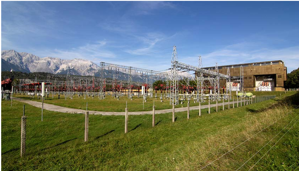
Kraftwerksgruppe Sellrain-Silz, Kraftwerk Silz, TIWAG
