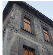
Verfällt: Verwaltungsgebäude des Bahnhofs Hauptzollamt
