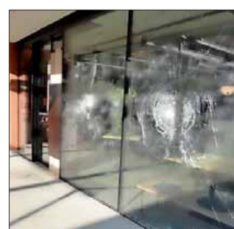
Gleich mehrere Scheiben von Gastlokalen waren durch Axthiebe beschädigt worden.
